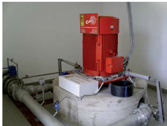
La turbine, de type Pelton à axe vertical, est alimentée par deux injecteurs.
